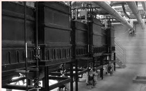
神戸工場(凝集沈殿設備)
