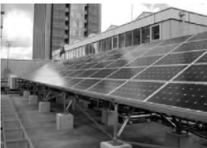
7号館屋上の太陽光発電設備
