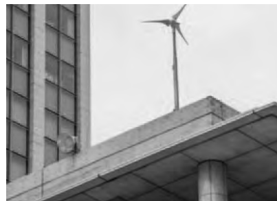
6号館屋上の風力発電設備
