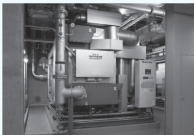
廃熱投入型ガス吸収式冷温水機(ジェネリンク) 3台
