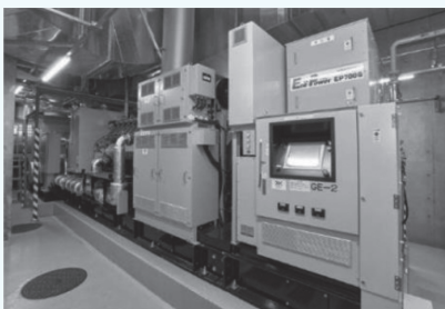
停電時対応型ガスコージェネレーションシステム 3台
