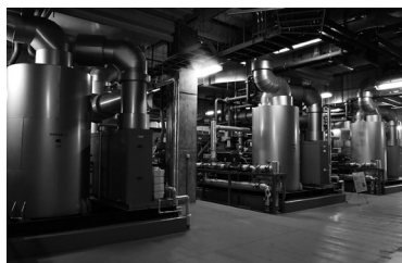
ガスエンジン
